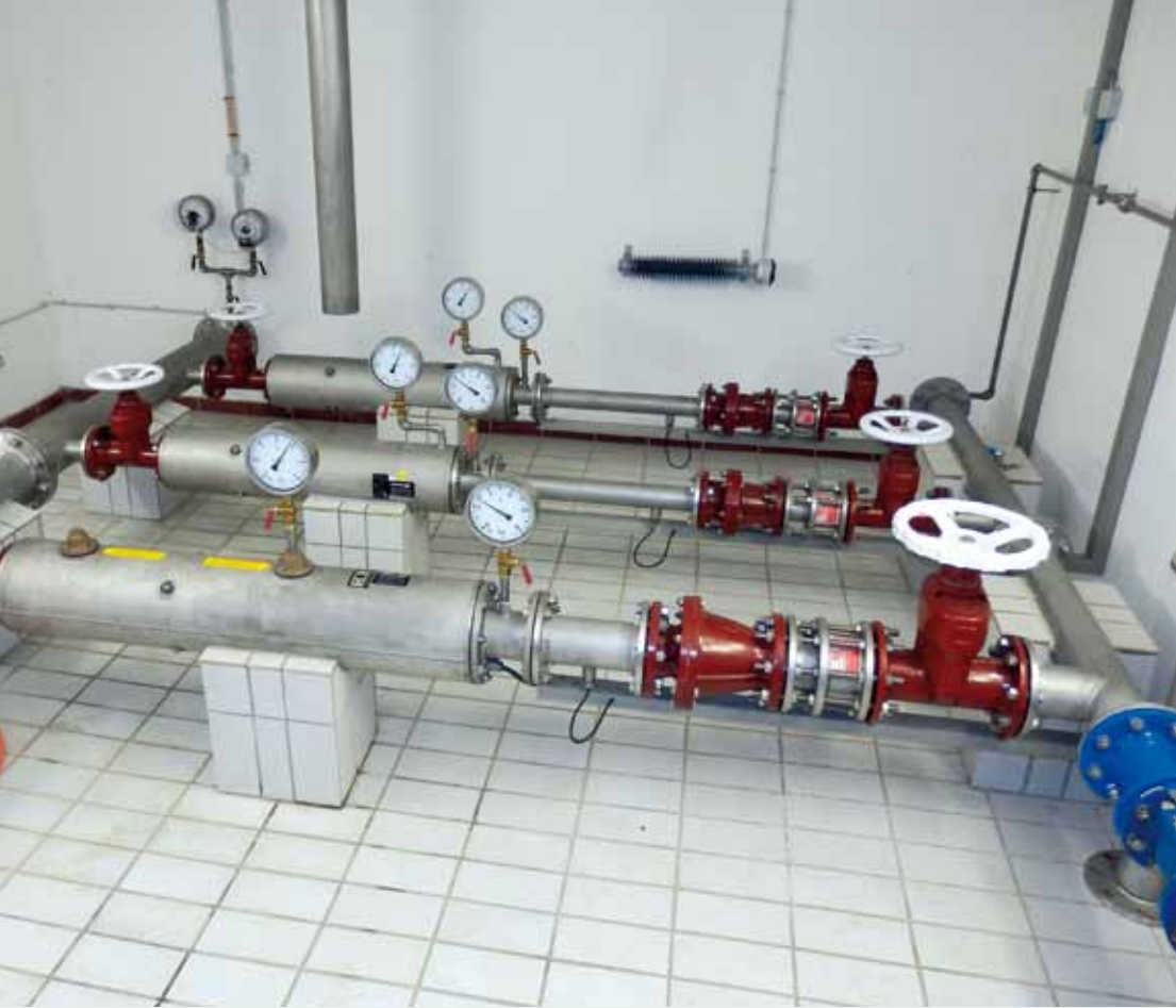
Innenansichten der Druck- steigerungs- anlage Einsbach
