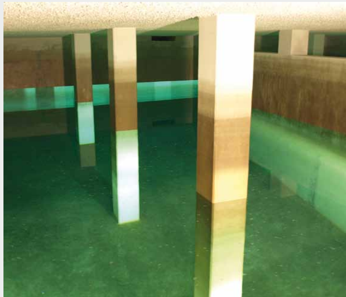
Wasserkammer des Hochbehälters
