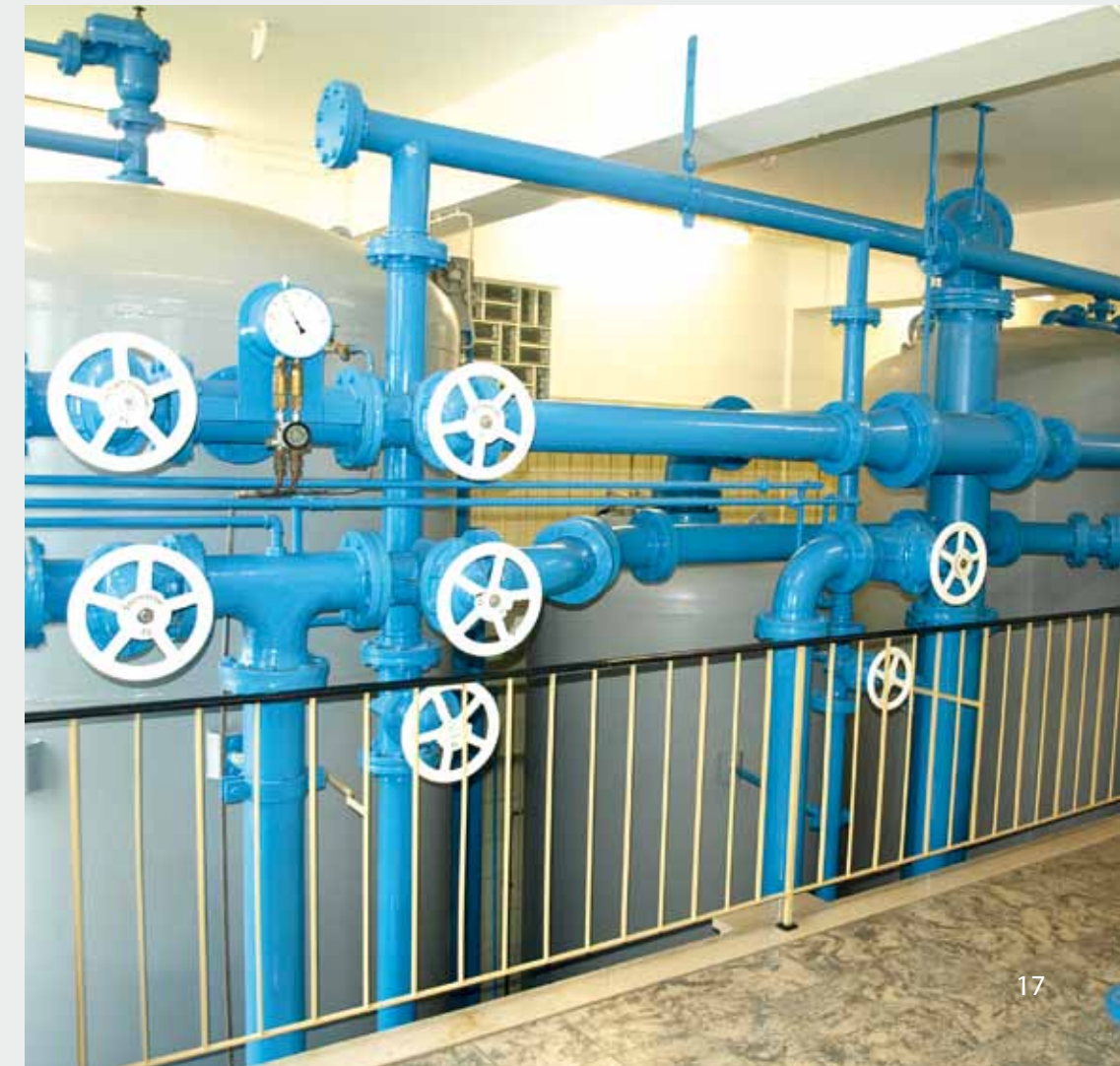
Innenansicht der Aufbereitungs- anlage (Teilbereich)
